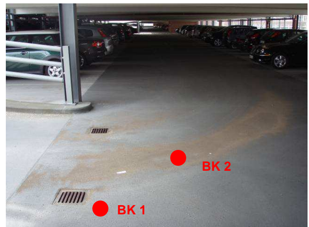
Bild 6: Verschleißerscheinungen eines OS 11b-Systems hinter einer Abfahrtsrampe im Kurvenbereich
