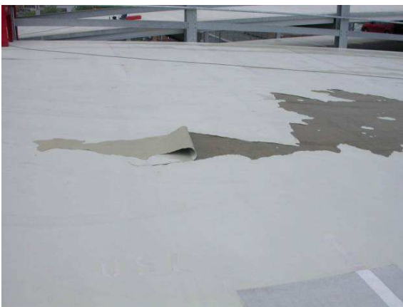
Bild 9: Großflächige Ablösung eines OS 11a-Systems auf einem Freideck
